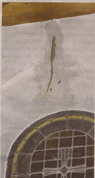
Risse in der Wand machen einen neuen Flächenverputz erforderlich.
